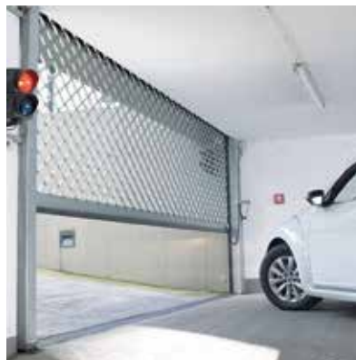
Rollgitter TG-A in einer Tiefgarage
